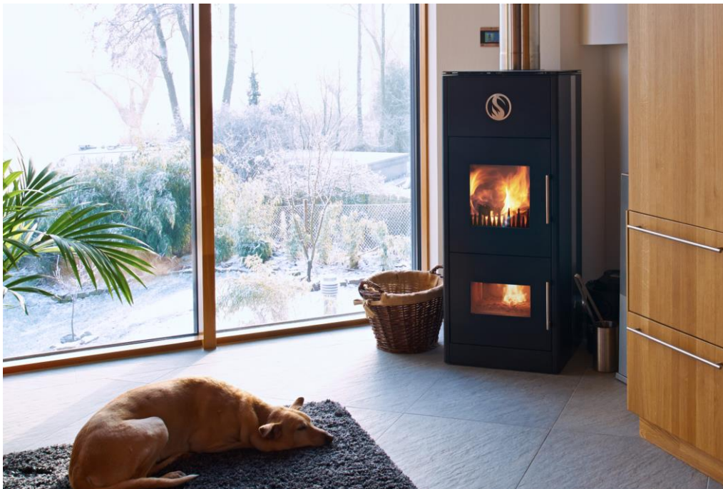
Wärmepumpe und Kaminofen – Die moderne Energiekombination
